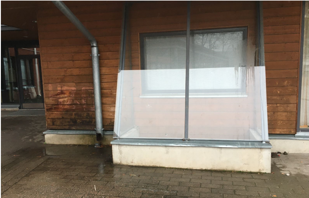
Kuva: Peruskorjauksen tarpeessa olevaa puuverhousta väestönsuojan hätäpoistumiskuilun takana
