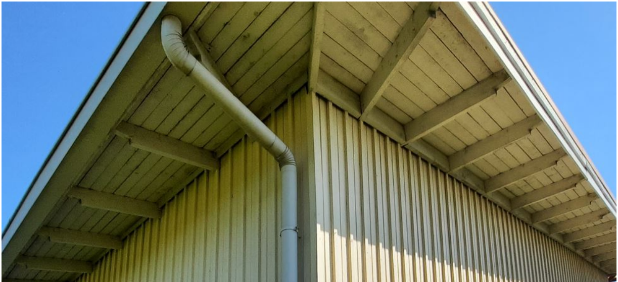
Kuva: Räystäsrakenteet uusitaan alkuperäisen mallin mukaan. Myös syöksytorvien malli ja väri säilytetään, vaikka ne uusitaankin kauttaaltaan.
