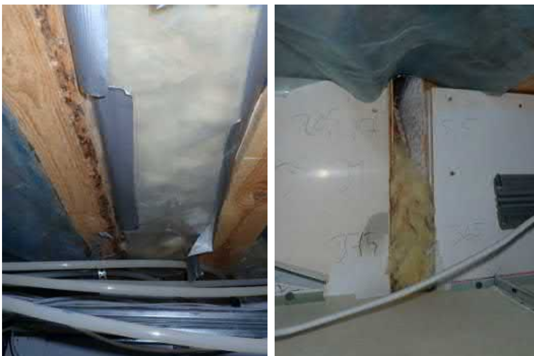
Kuvat 48 ja 49. Höyrynsulkua on yritetty paikata teipillä. Väliseinien mineraalivillat ovat näkyvillä.
