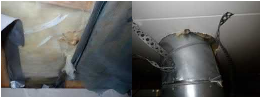
Kuvat 46 ja 47. Alakattojen päällinen höyrynsulkumuovi tai läpiviennit eivät ole tiiviitä.
