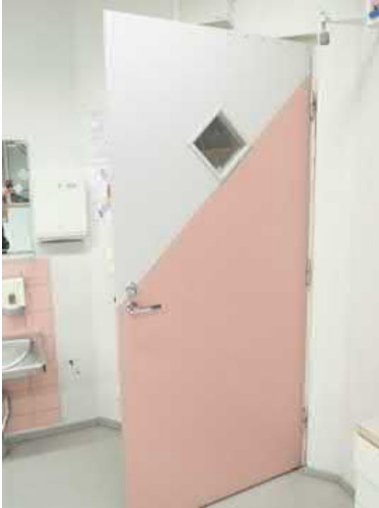
Kuva 22. Sisäovien malli. Sisäovissa on todettu irronneita tiivisteitä ja maalipintavaurioita tiloissa 123 ja 138. Tilassa 123 sisäoven karmeissa oli pientä mekaanista vauriota, mutta se ei vaikuttanut oven toimivuuteen
