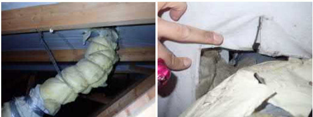
Kuvat 40 ja 41. Läpiviennit eivät ole tiiviitä.
