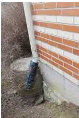
Kuva 3. Sadevesien syöksyputkien alaslaskuja on jatkettu, jotta vesi saadaan ohjattua kauemmaksi sokkelin vierustalta.
