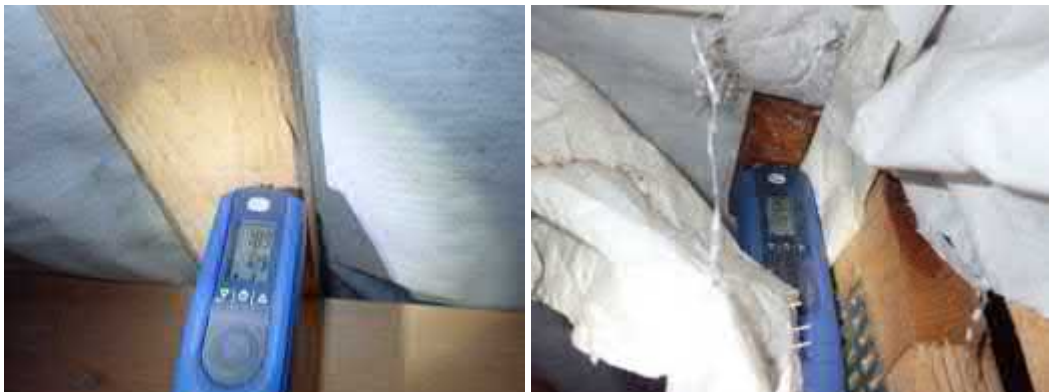
Kuvat 38 ja 39. Ruodelaudoitus on paikoin kastunut.
