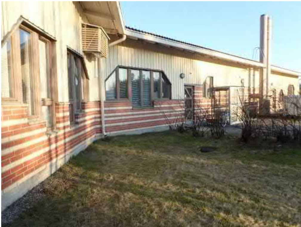
Kuva 30. Kasvillisuutta on sokkelin pinnassa asti.
