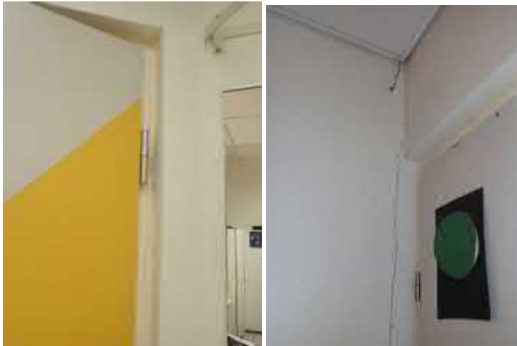
Kuvat 25 ja 26. Tila 123. Väliovien kohdalla havaittiin väliseinissä pystyhalkeamia.
