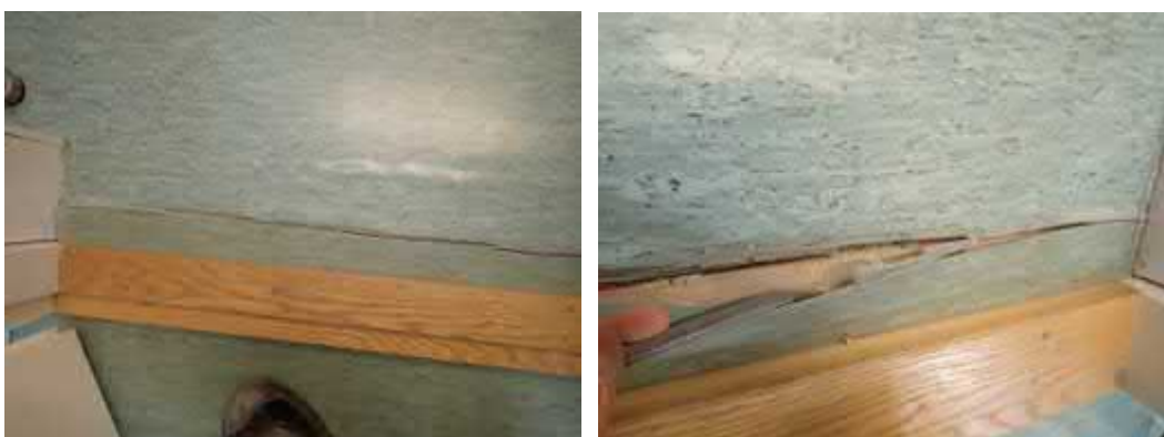
Kuvat 14 ja 15. Pinnoite on irti lattiasauman kohdalla.
