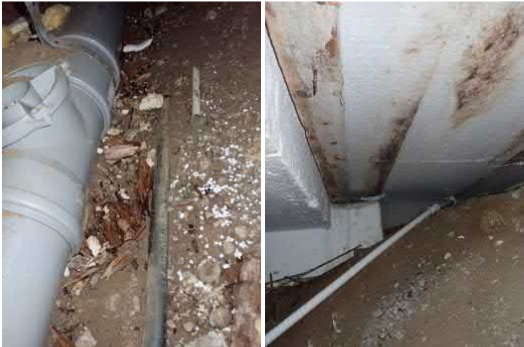
Kuvat 6. ja 7. Ryömintätilan pohjalla ja eristeissä on kastunutta puumateriaalia. Paikoin maanpinta on lähellä alapohjan lämmöneristeiden alapintaa.
