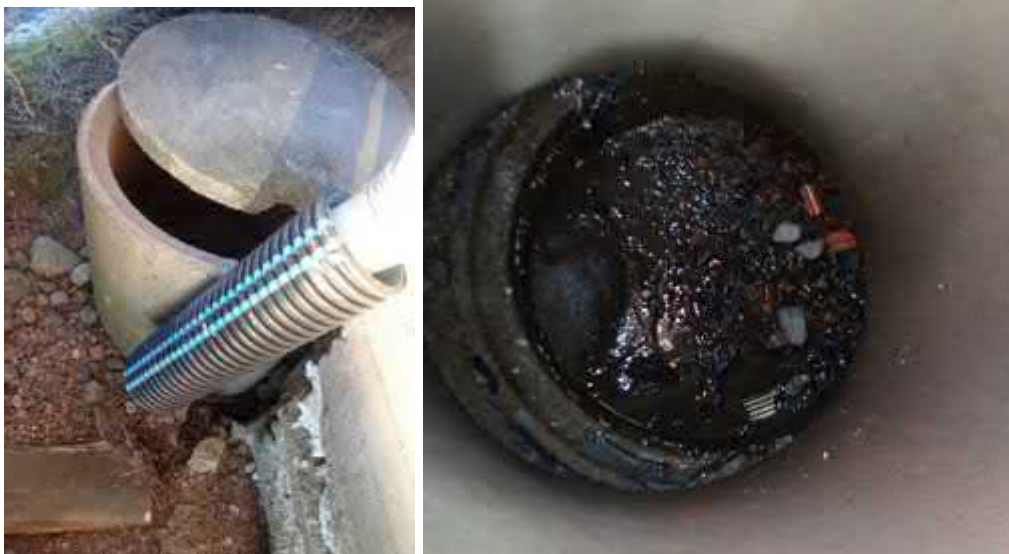
Kuvat 28 ja 29. Sadeveden ohjaus on puutteellinen. Vedet pääsevät valumaan sokkelia pitkin.
