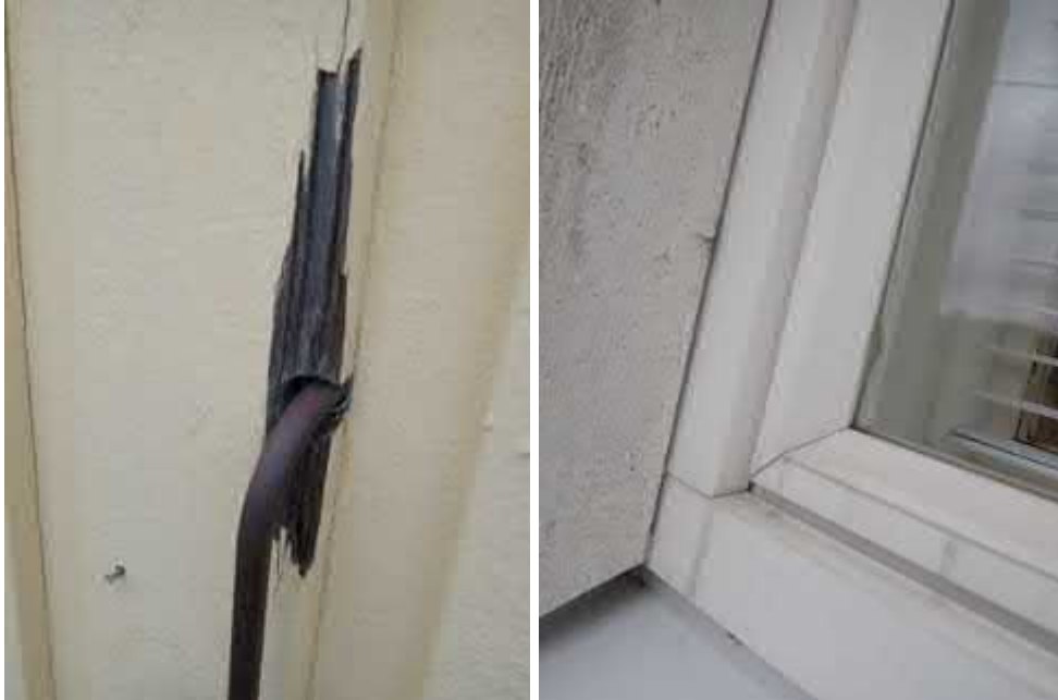
Kuvat 19 ja 20. Ulkoseinän julkisivulaudoitus on vaurioitunut IV-koneiden vedenpoistoputken kohdalla. Ikkunat ovat ulkoapäin hyvässä kunnossa.
