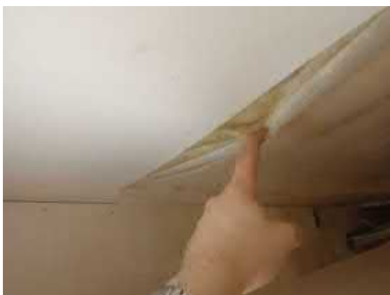
Kuva 52. Yläpohjan höyrynsulku on avoin kipsilevyn katkaisukohdassa.
