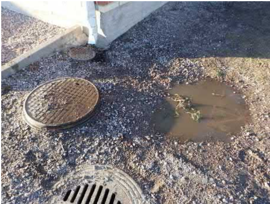
Kuva 27. Sadeveden ohjaus on puutteellinen.
