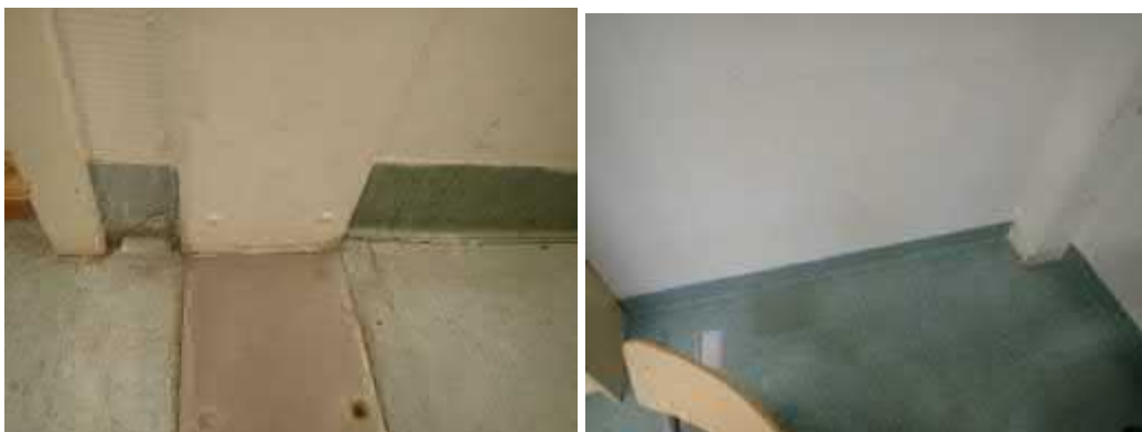
Kuvat 12 ja 13. Pinnoitteen seinäliittymässä on paikoin halkeamia ja koteloinnin alaosa on vaurioitunut.
