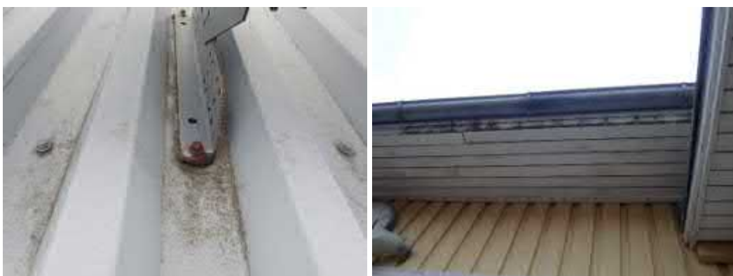
Kuva 35. Kulkusillan kiinnitykset ovat ruostuneet. Räystääkourujen viereinen lauta on vaurioitunut.
