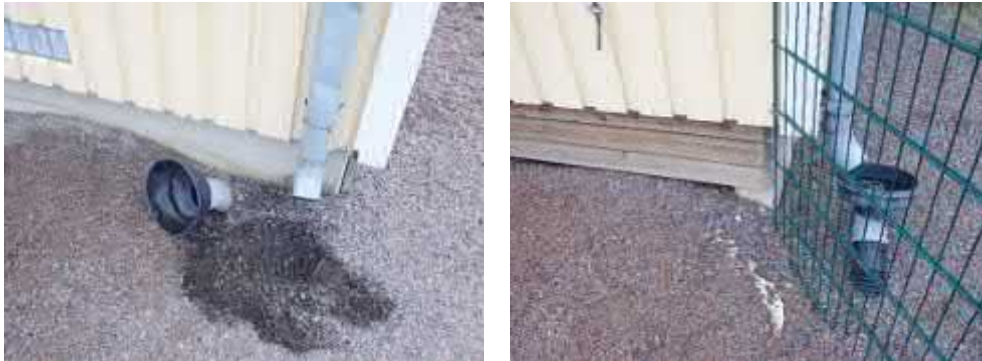
Kuvat 23 ja 24. Sadevettä ohjautuu sokkelin vierelle.
