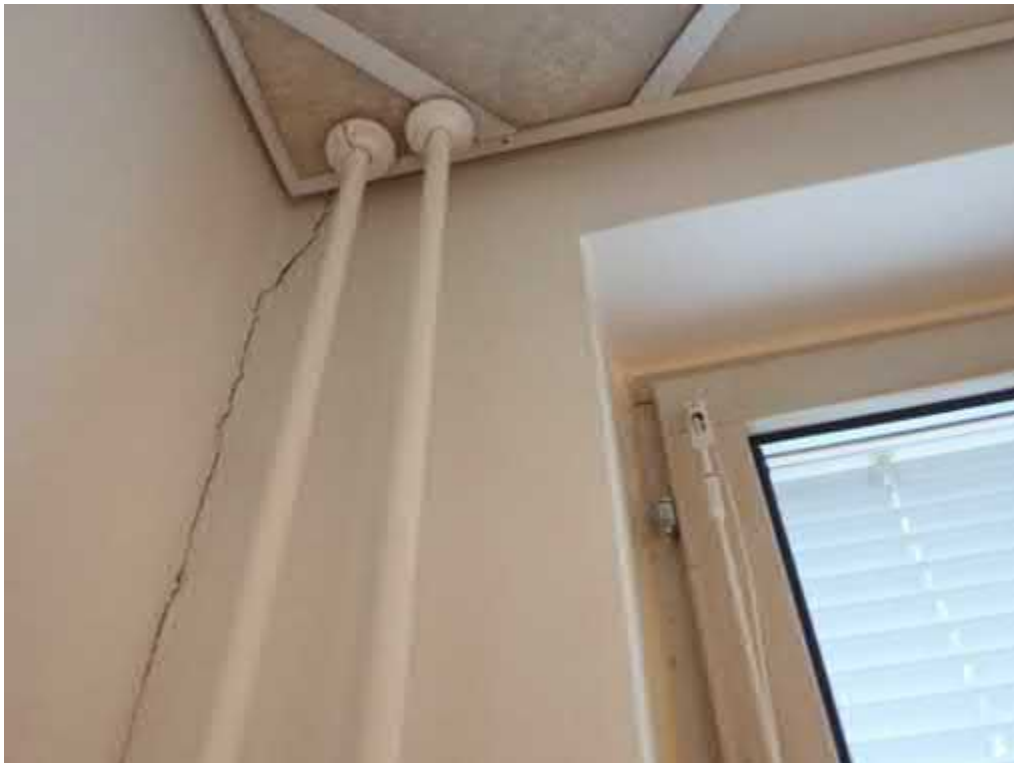
Kuvat 12 ja 13. Pääsisäänkäyntiä vastapäätä ulkoseinien liittymässä on sauma auennut.
