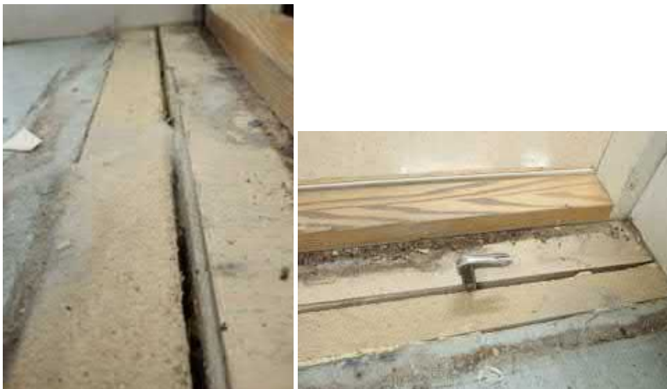
Kuvat 16 ja 17. Tilan P06 oven kynnyksen peltiastian alla olevasta lattiasaumasta todettiin lievää ilmavirtaa sisätiloihin päin merkkiainesavun avulla.
