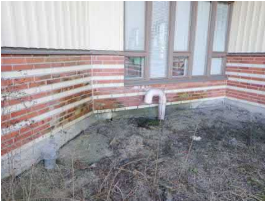
Kuva 16. Muilla julkisivuilla, joissa on istutusalueita lähellä ulkoseinää, julkisivujen alaosissa on sadevesiroiskeiden aiheuttamaa likaa ja leväkasvustoa.
