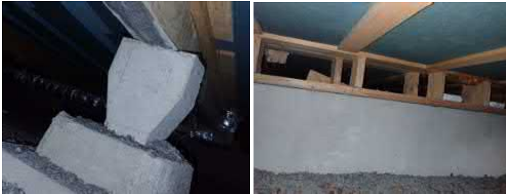
Kuvat 7 ja 8. Alapohjan kantavat puupalkit on tuettu betonianturoilla ja betonisokkelilla. Betonin ja puuosien välissä on irrotuskaista.
