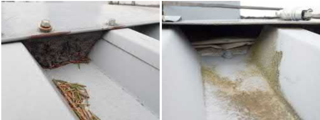
Kuvat 31 ja 32. Harja- ja katepellin raot on paikoin täytetty vaahтомуovilla. Aukinaisissa kohdissa aluskatetta ei ole limitetty pellin alle.
