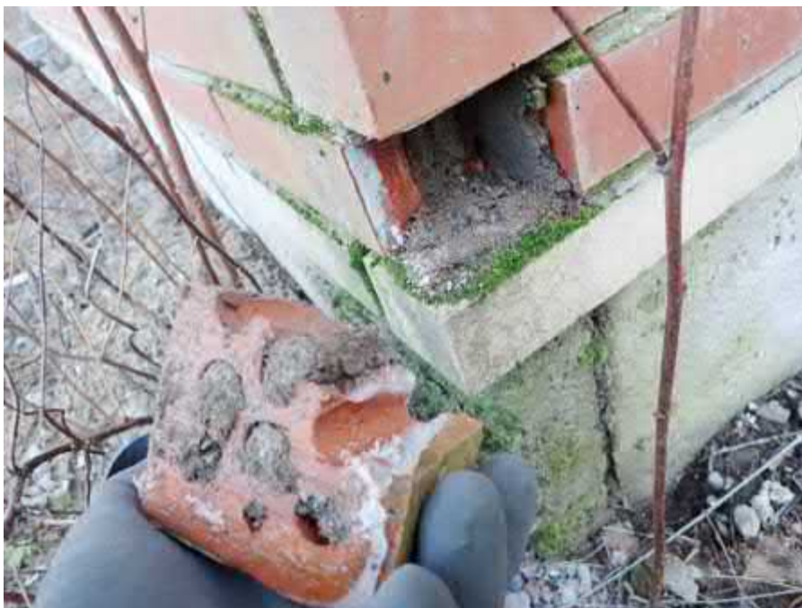
Kuva 17. Julkisivujen tiilimuurausten saumoissa on paikoin laastisaumat rapautuneet. Ulkoseinien nurkkakohdissa oli yksittäisistä tiilistä rapautunut osa irti.
