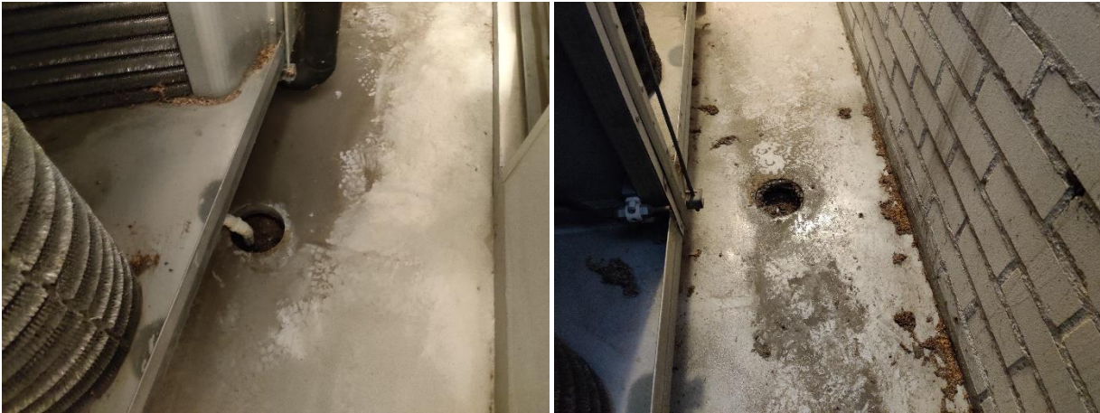
Kuva 30. Tuloilmakammion viemäröinnit olivat tukkeutuneet. Kammion ulkoseinässä vedeneristysnosto noin 5 cm:n korkeudelle.
