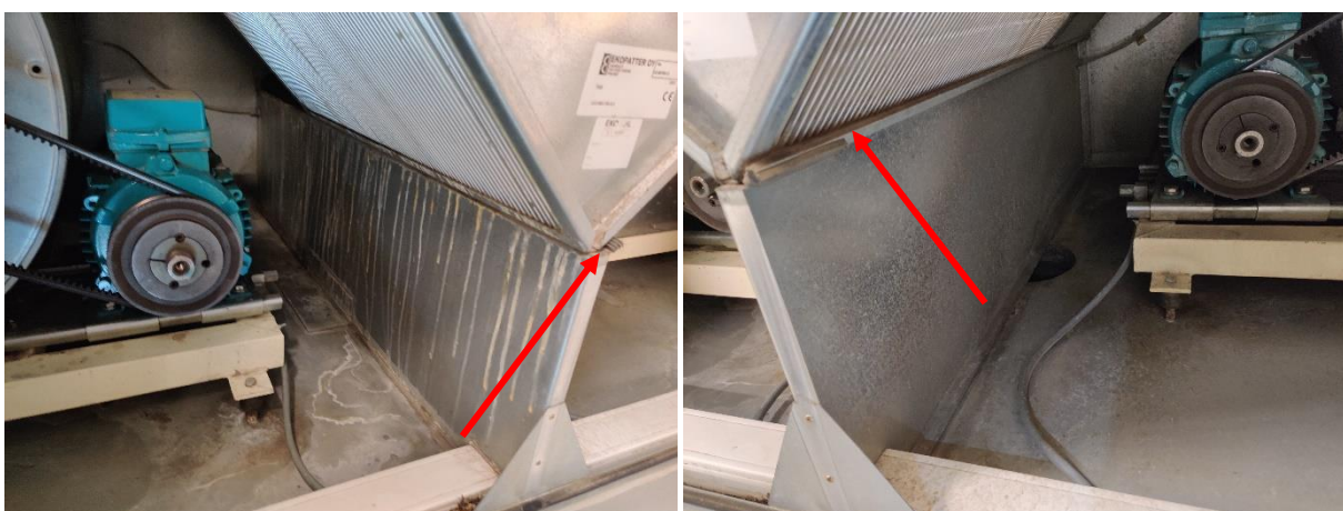
Kuva 38. tuloilmapuhaltimelle kulkeutuu LTO:n lävitse vettä tai vesi valuu poistupuolen pinnalta LTO:n alle asetetun tiivisteen vuoksi. (punainen nuoli)
