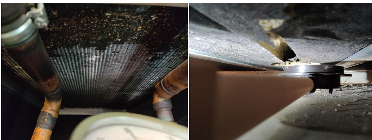
Kuva 39. Tulopuolen lämmityspatteri on osittain peittynyt hyönteisistä. Koneen viemäröinti on puutteellisesti toteutettu.
