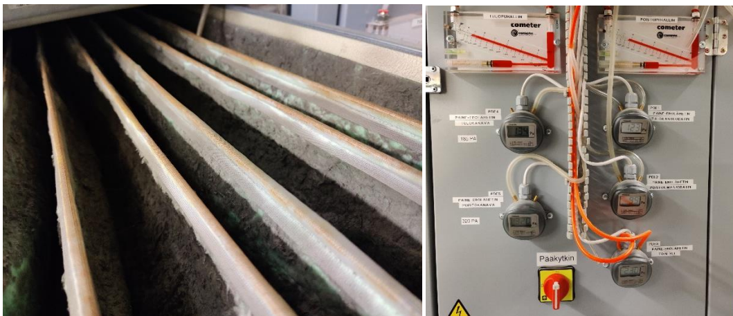
Kuva 37. Tulosuodattimet olivat melko likaiset. Paine-erolähtetimestä havaittiin tulokanavan paineen jäävän asetusarvosta.
