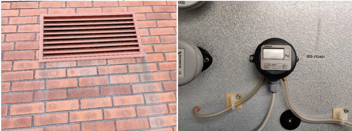
Kuva 34. Rakennuksen seinäpinnalla sijaitsevan ulkoilmalaitteen alapuolisessa seinäpinnassa oli selviä veden aiheuttamia valumajälkiä. Koneen tuloilmasuodattimen paine-eromittarin näyttö ei toiminut.
