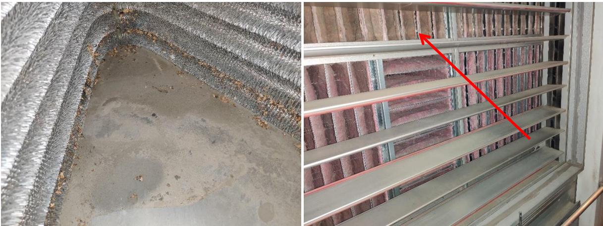
Kuva 31. Neulalämmönsiirrinten pinnassa havaittiin pieniä määriä orgaanisia epäpuhtauksia. Osa TK1:n tuloilmasuodattimista vaikutti muita likaisemmilta (punainen nuoli).
