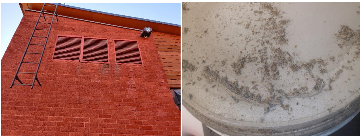
Kuva 36. TK4:n ja TK5: ulkoilmäsäleiköt. Ulkoilmakanavan alapäässä olevan päätyluukun päällä oli epäpuhtauksia.
