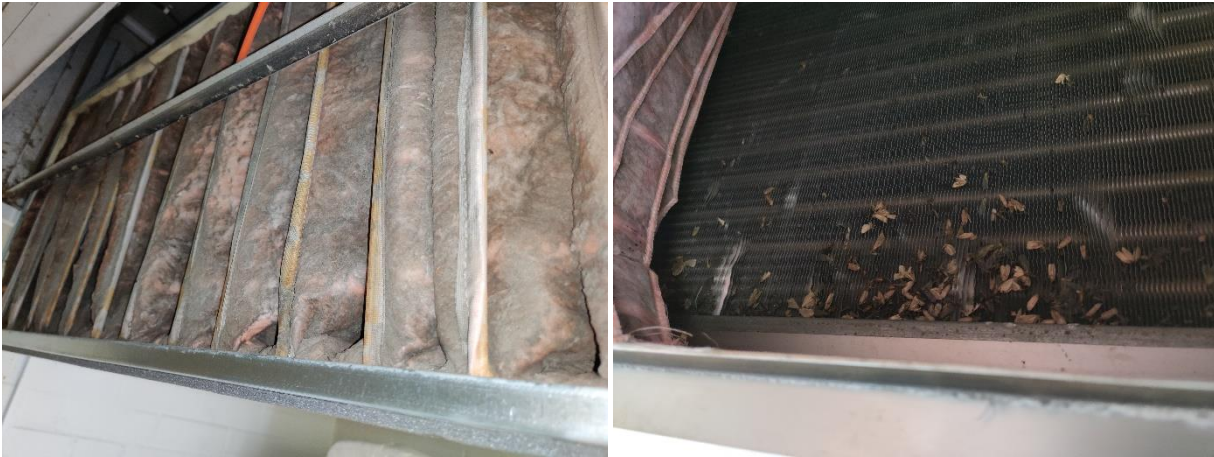
Kuva 35. Tulosuodattimet olivat melko likaiset ja niissä havaittiin merkkejä suodattimien ajoittaisesta kastumisesta. Lämmityspatterin pintaan tarttuneet hyönteiset kertovat ohivirtauksesta.
